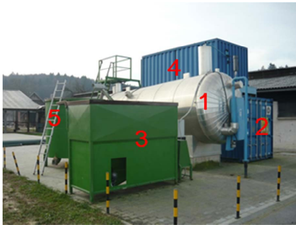
Slika 2: Mikro bioplinska naprava modularne izvedbe (skupni razvoj MIBP, Omega air – Kmetijski inštitut Slovenije), 1 – reaktor (digester), 2 – strojnica s čiščenjem plina, kogeneratorsko enoto in zalogovnikom toplotne energije, 3 – predpriprava trdnega substrata (mletje in dozacija), 4 – zalogovnik bioplina, 5 – predpriprava tekočega substrata – hidroliza (vir: Kmetijski inštitut Slovenije, Oddelek za kmetijsko tehniko in energetiko)
