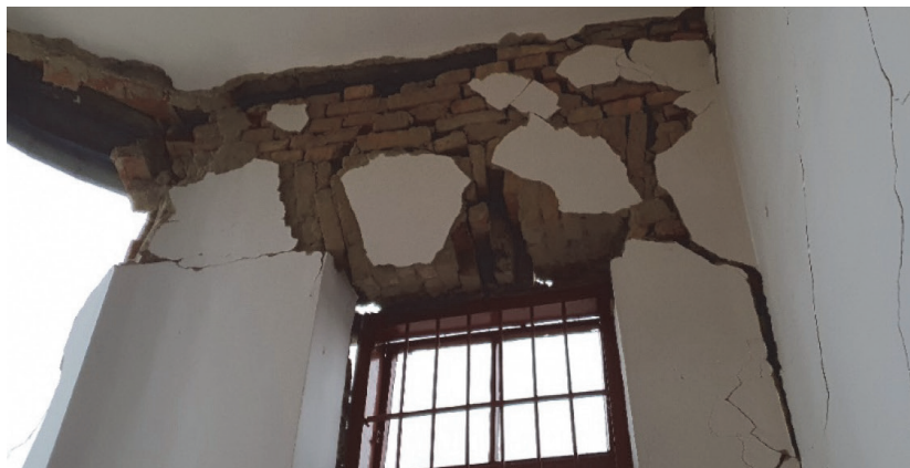
Slika 77. Fotografija teško oštećenoga nadvoja u stanju sloma
