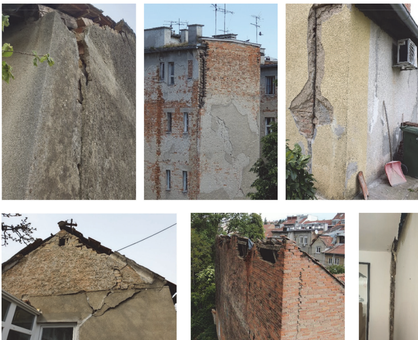
Slika 58. Fotografije oštećenja konstrukcije povezane s mehanizmom sloma zidova izvan ravnine
