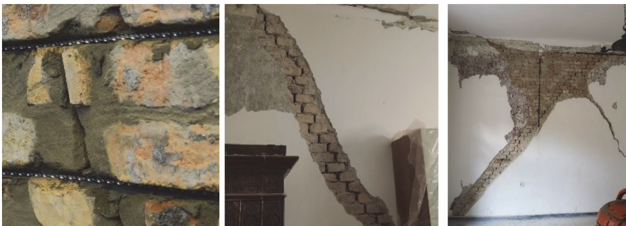
Slika 56. Fotografija oštećenja zidova
