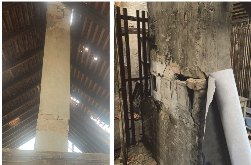
Slika 7. Oštećenja dimnjaka u razini tavanjskoga prostora
