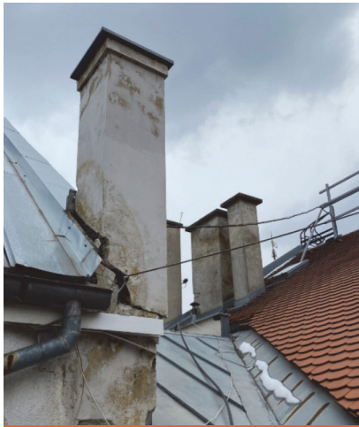
Slika 8. Teška oštećenja (slom) dijelova dimnjaka iznad krovne konstrukcije
